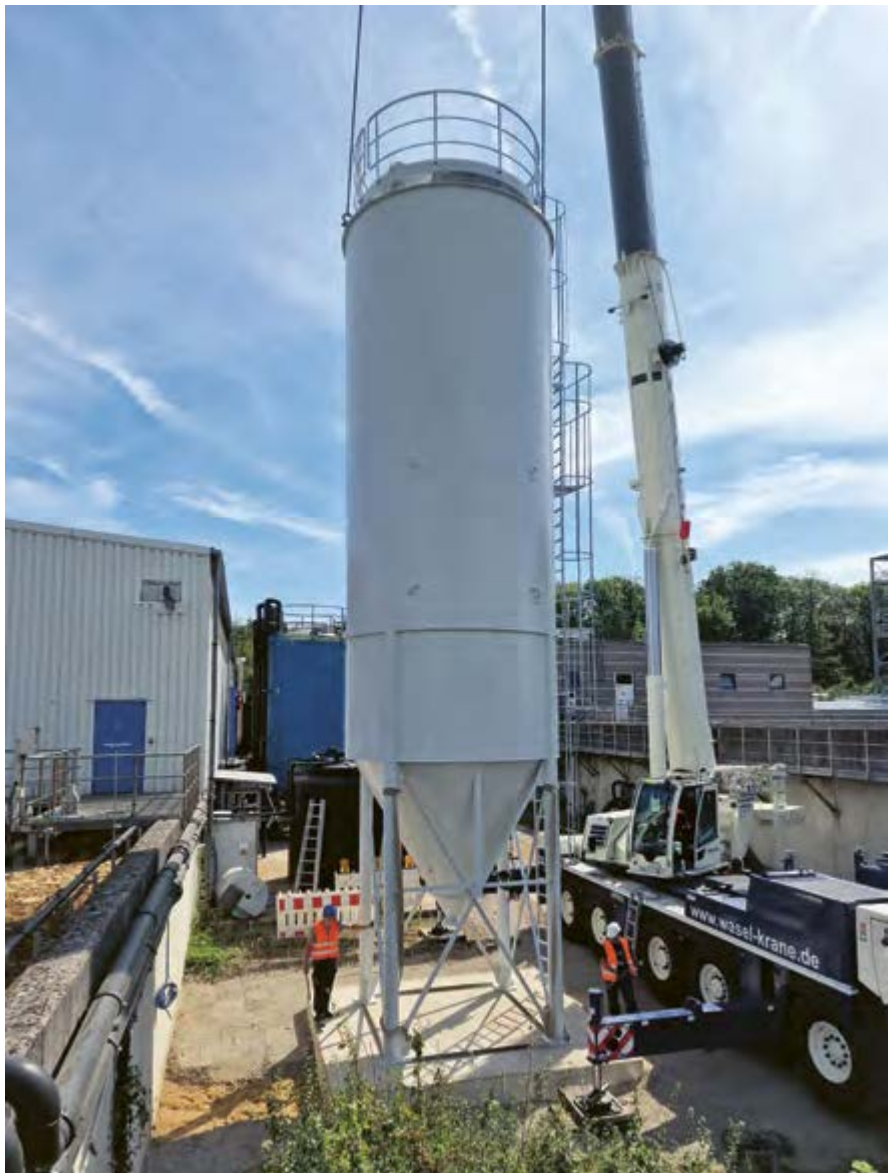
Silo für Pulveraktivkohle, GKW Nordkanal
