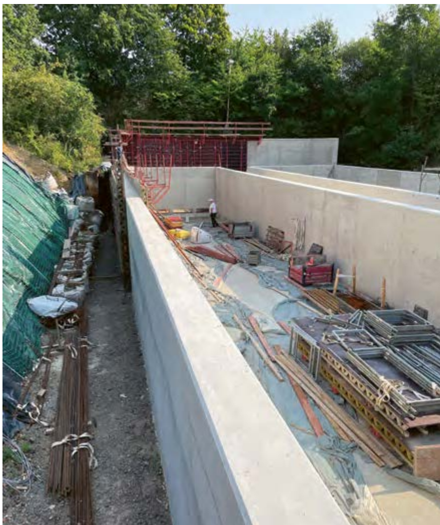
Meckenheim-Kottenforst: Absetzkammern des neuen Regenklärbeckens
