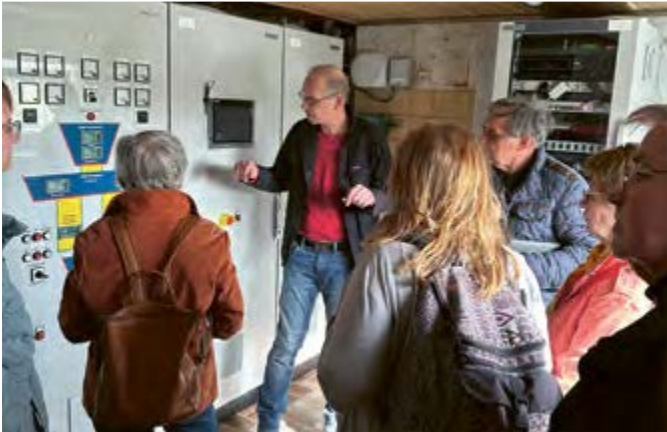
Einblick in die Warte des Hochwasserrückhaltebeckens Horchheim, 21. März
