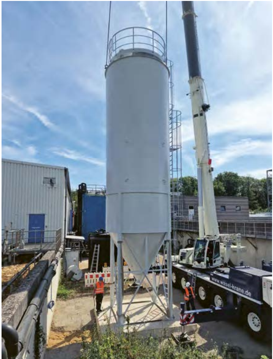
Silo für Pulveraktivkohle, GKW Nordkanal
