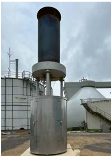
Neue Gasfackel und sanierter Faulturm (im Hintergrund) auf der KA Köttingen
