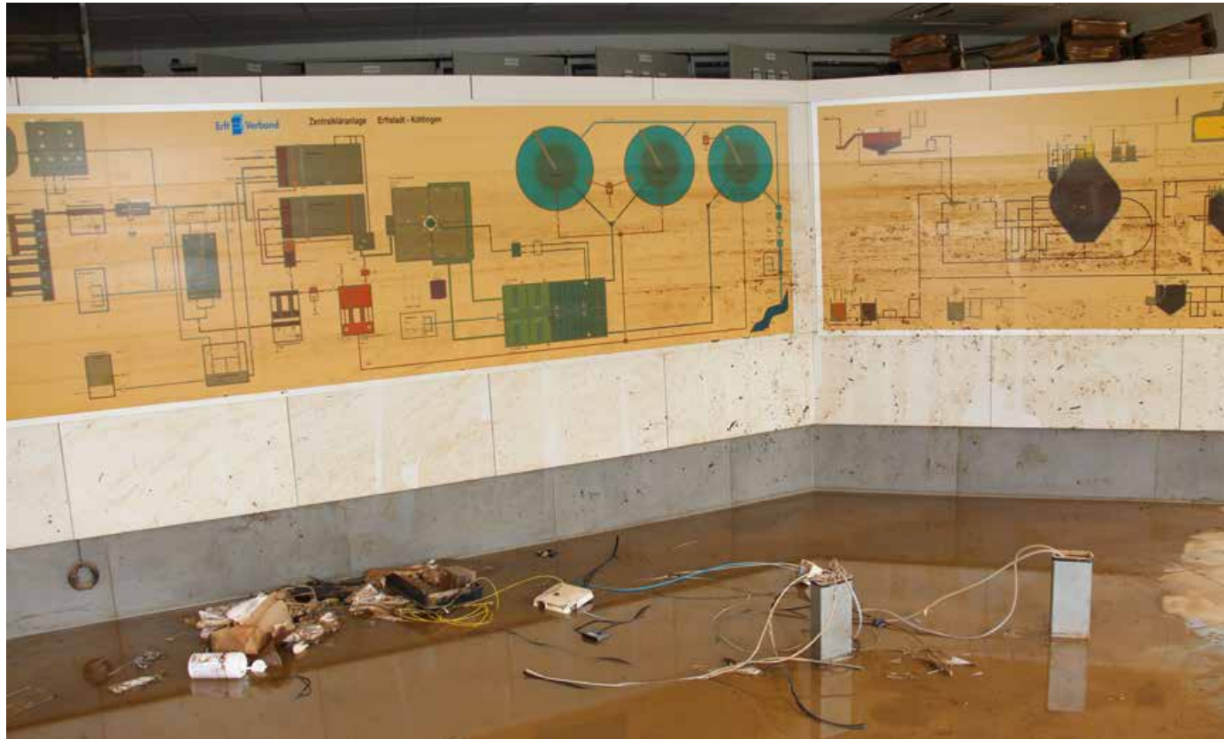
Zerstörte Schaltwarte der KA Köttingen
