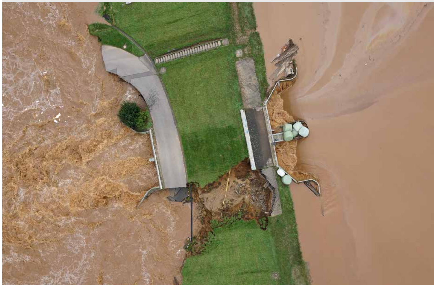
Beschädigter Damm des HRB Horschheim
