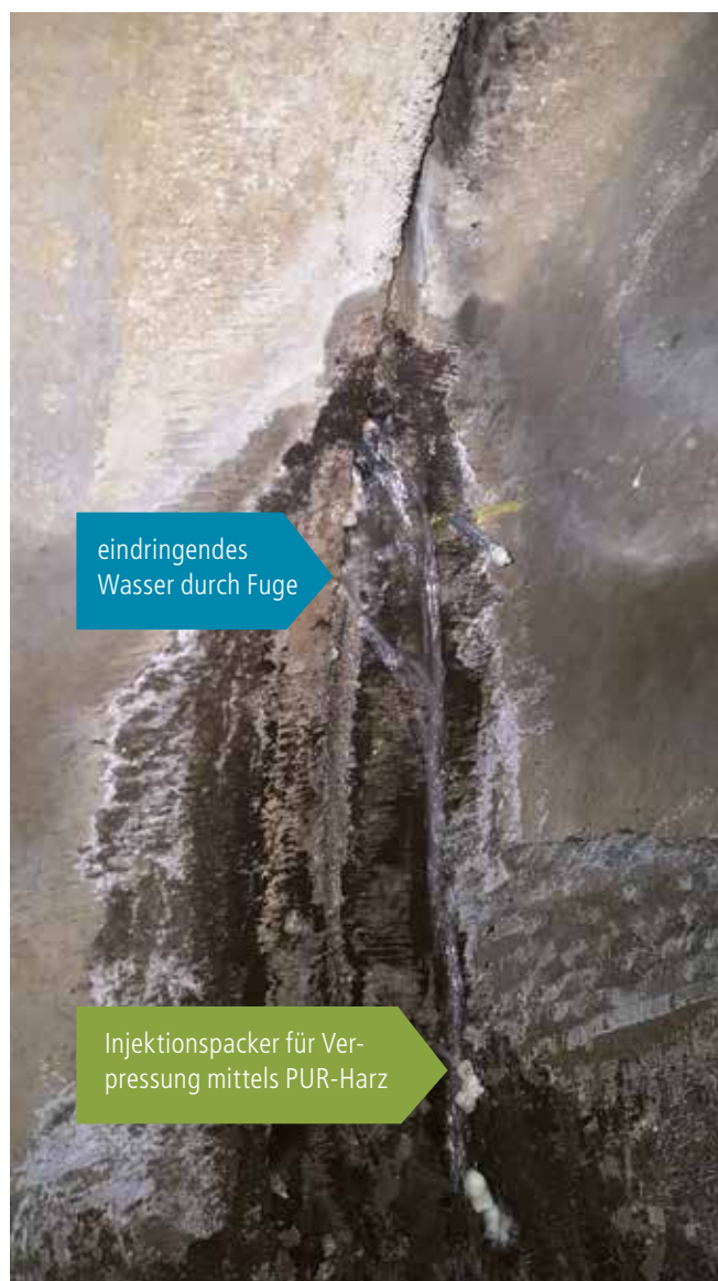
Beispiel von eindringendem Wasser durch eine Fuge in der Kanalisation
