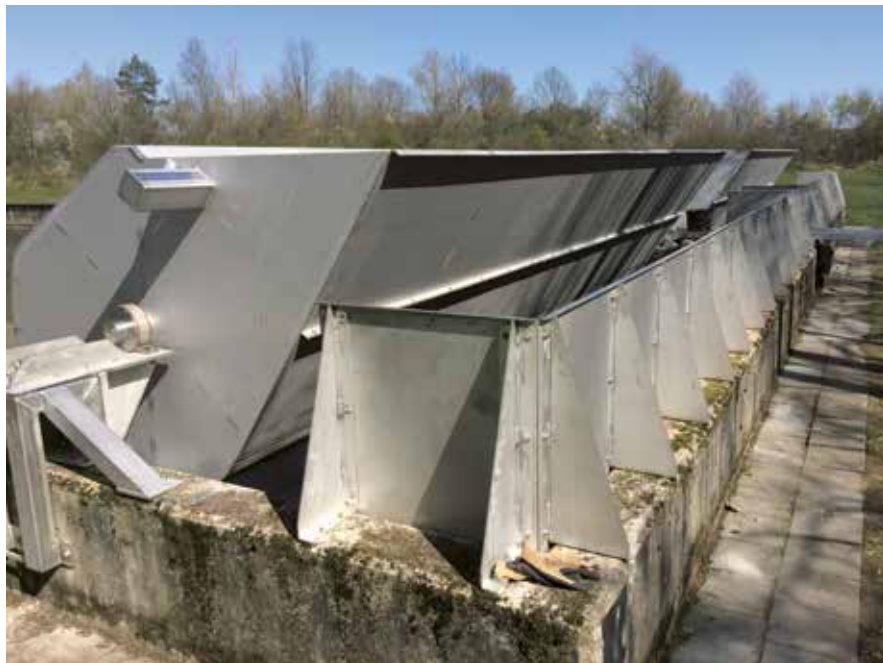
Spülkippe RÜB Mastenweg
