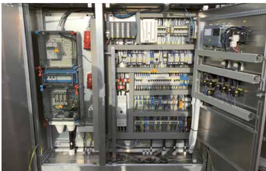
Blick in den ertüchtigten Schaltschrank
