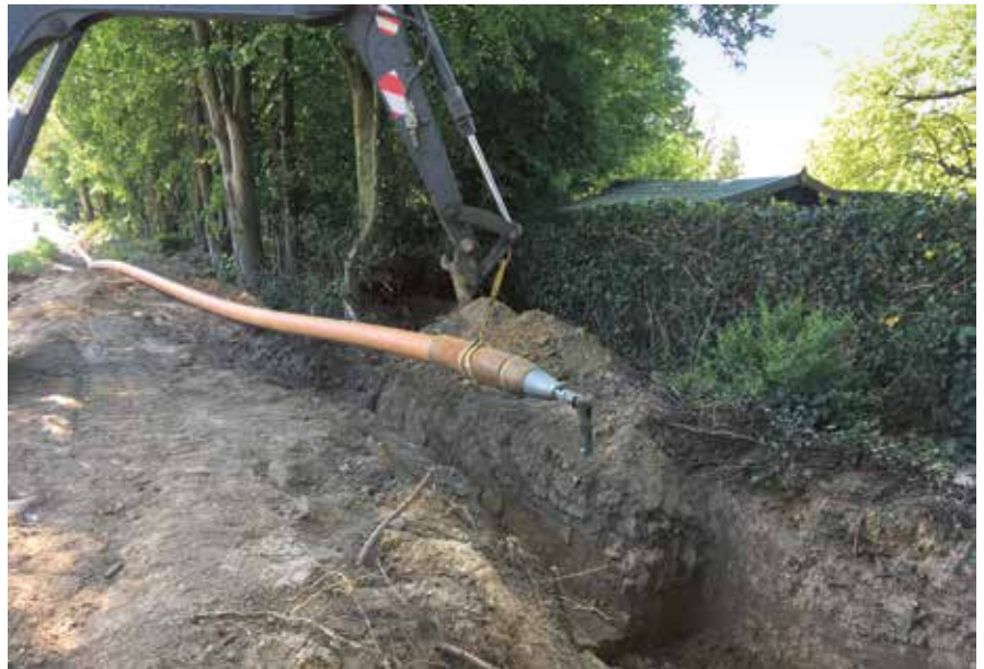
Berstkopf, einschließlich Rohrleitung
